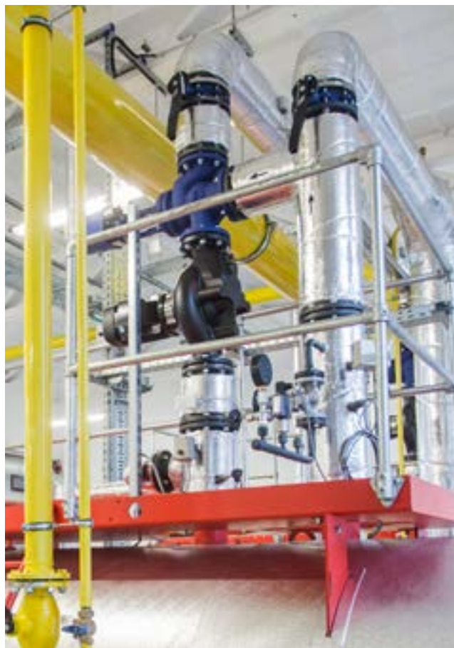
Jištění teploty vstupní vody RTS
