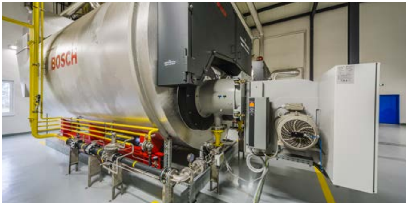
Pohled na kotel Bosch
