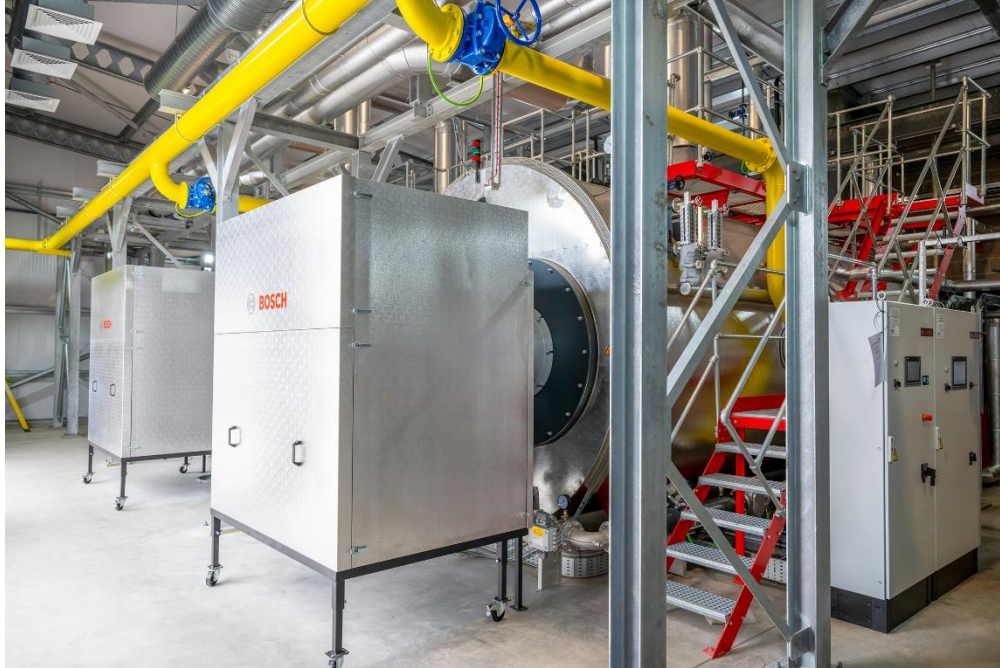
Bild_01: Powered by Bosch: Die weltweit größte Molkerei betreibt am Standort Stranraer eine neue Dampfkesselanlage von Bosch.
