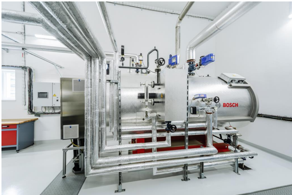
Bild_02: Der Bosch-Elektrodampfkessel ELSB in der Molkerei Střibro nutzt überschüssigen Strom zur Dampferzeugung.
