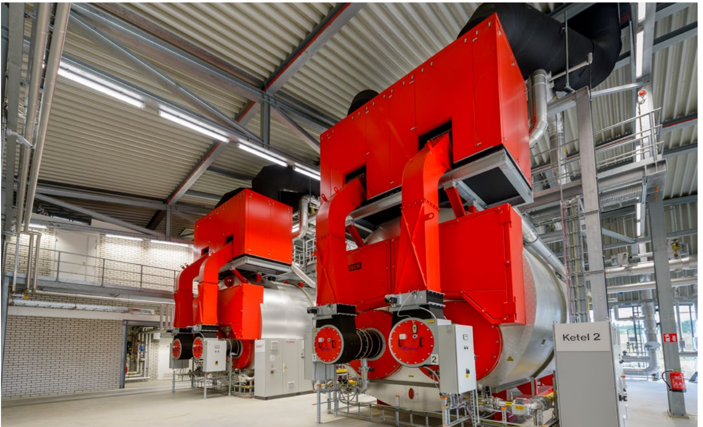
Abbildung 14: Kräftiges Rot ziert die Bosch-Kessel im Heizkraftwerk Pieter Wiersma in den Niederlanden
