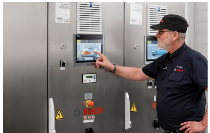
Abbildung 12: Bosch-Schaltschrank, ausgeführt in gebürstetem Edelstahl
