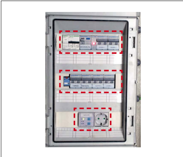
Imagen 5. Detalle de componentes en cuadro eléctrico.
