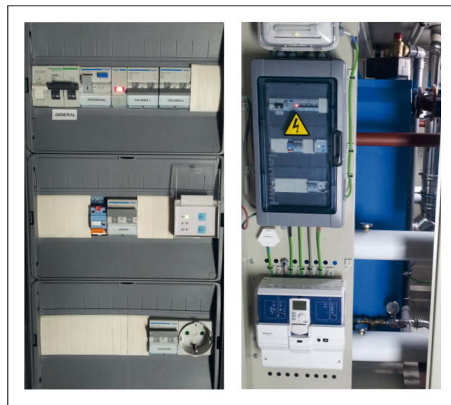
Imagen 10. Detalle de instalación eléctrica y de control en un equipo de dos calderas GB312
