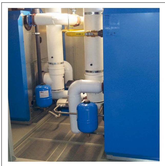
Imagen 9. Ejemplo de armario con dos calderas GB312 de 240 kW cada una.
