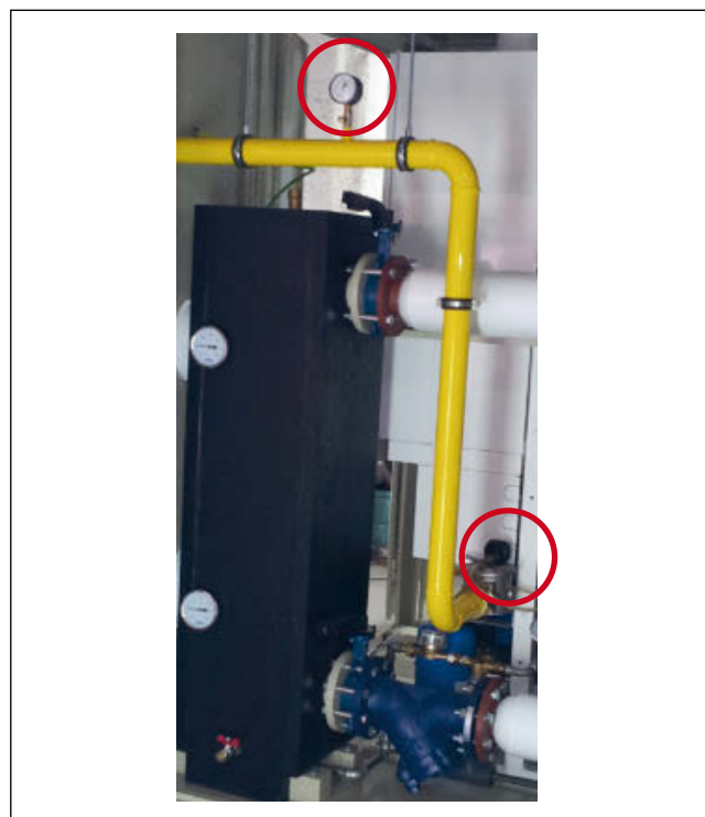
Imagen 3. Detalle de conexión de gas a calderas en equipos autónomos de generación de calor con GB162 V2.
