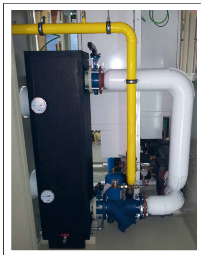
Imagen 2. Detalle de hidráulica de un equipo autónomo de generación de calor compacto formado por 3 calderas
