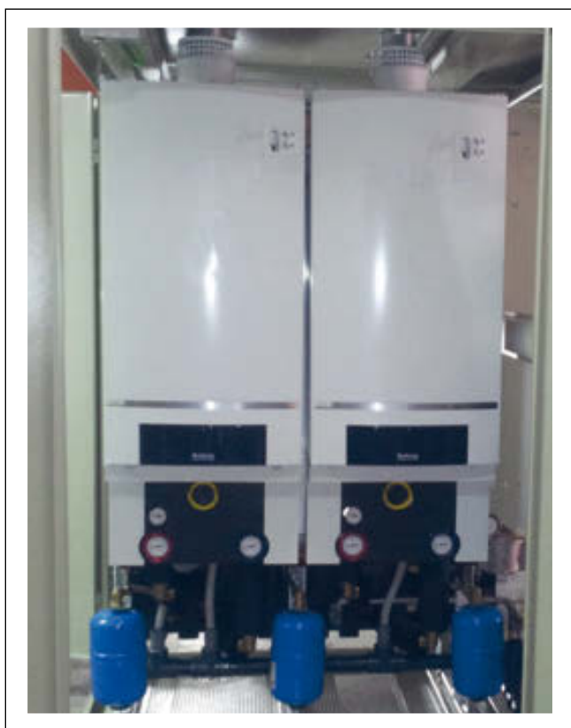
Imagen 1. Frontal de equipo autónomo de generación de calor formado por 3 calderas.
