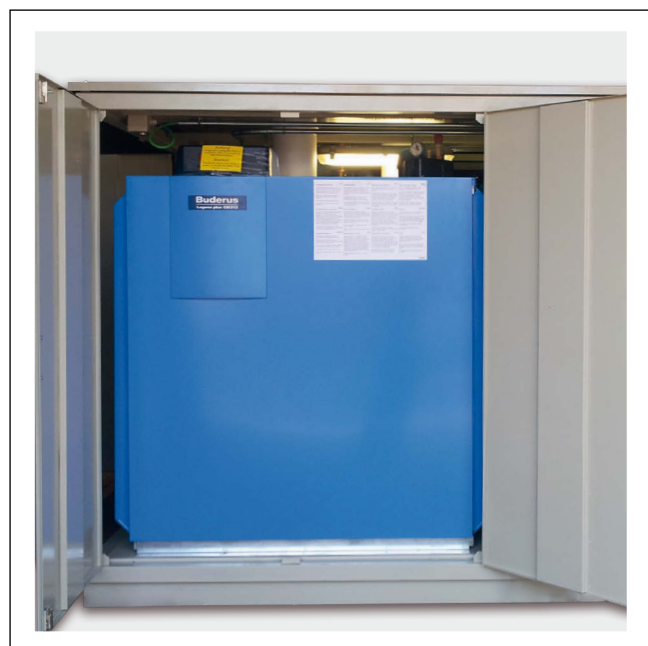
Imagen 8. Ejemplo de armario con dos calderas GB312 de 240 kW cada una.
