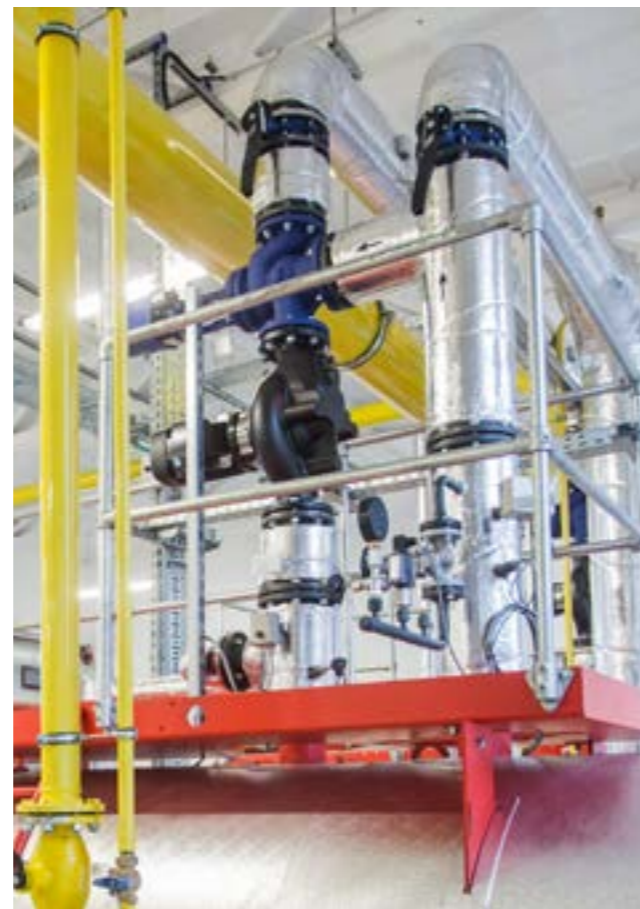
Control de temperatura de retorno RTS
