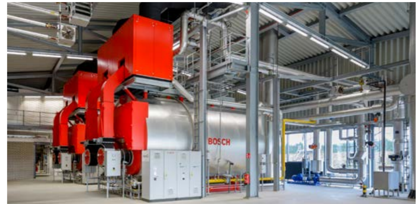
Los valores de NO x son inferiores a 50 mg/Nm 3 en el sistema de calderas personalizado de la central de calefacción Pieter Wiersma.
