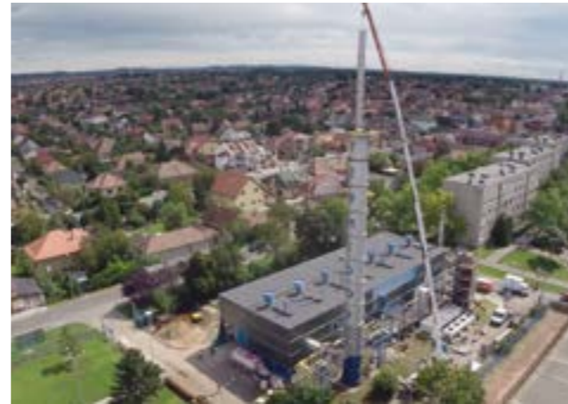
Planta de calefacción de Dunakeszi Közüzemi Kft. durante la fase de modernización.
