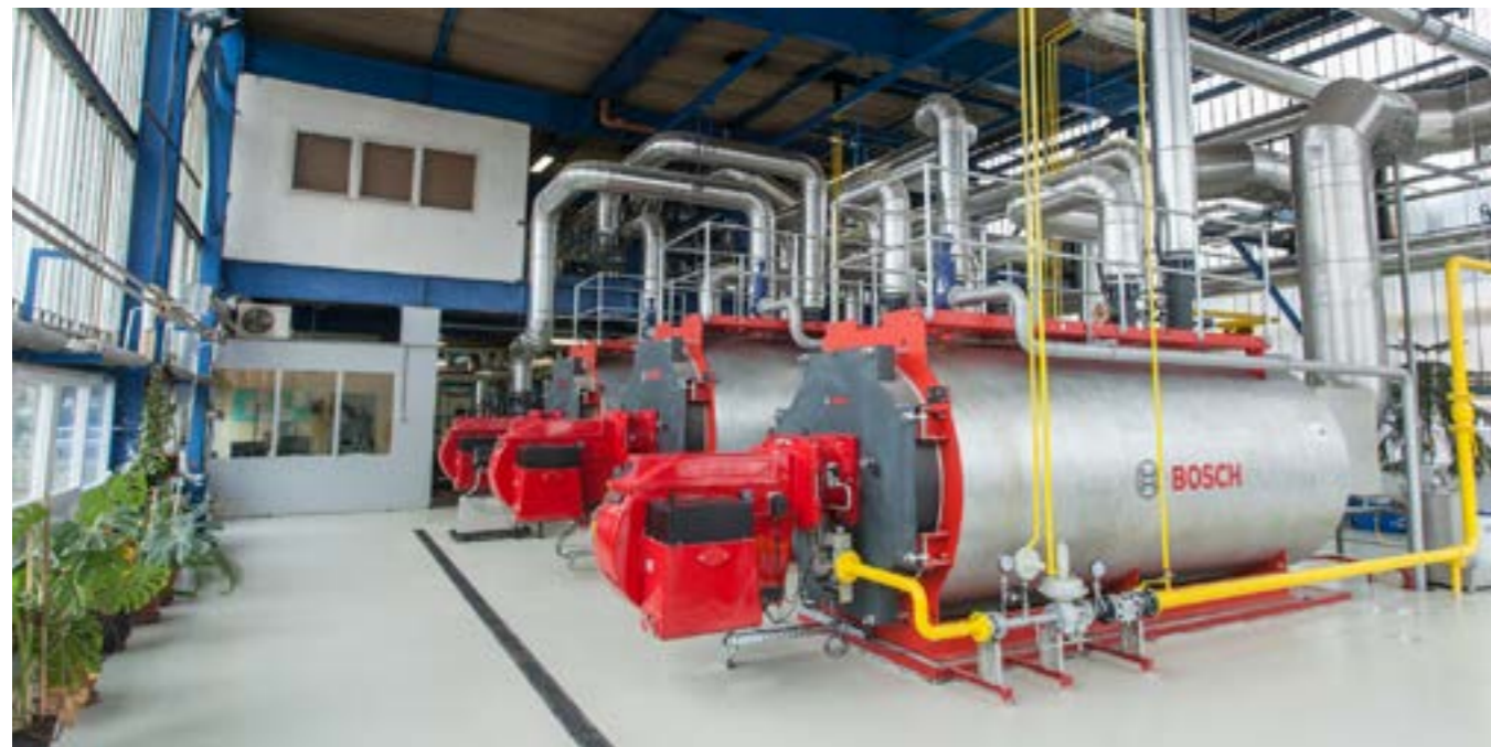
Actualización a la tecnología más moderna con nuevas calderas de calefacción Bosch.
