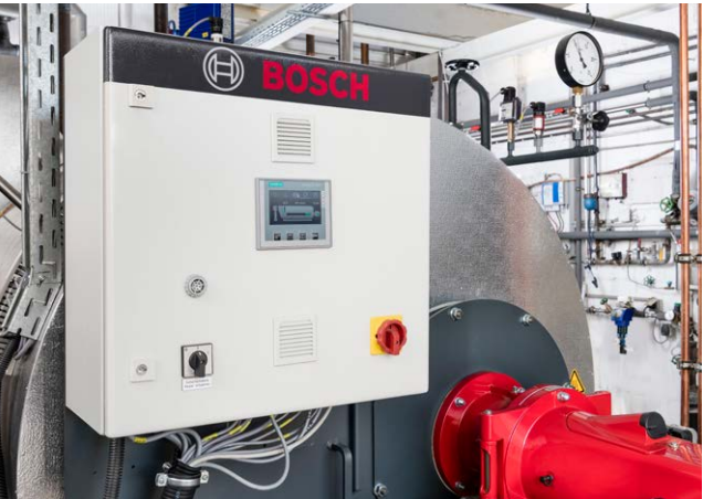
Kompaktní řízení parního kotle CSC
