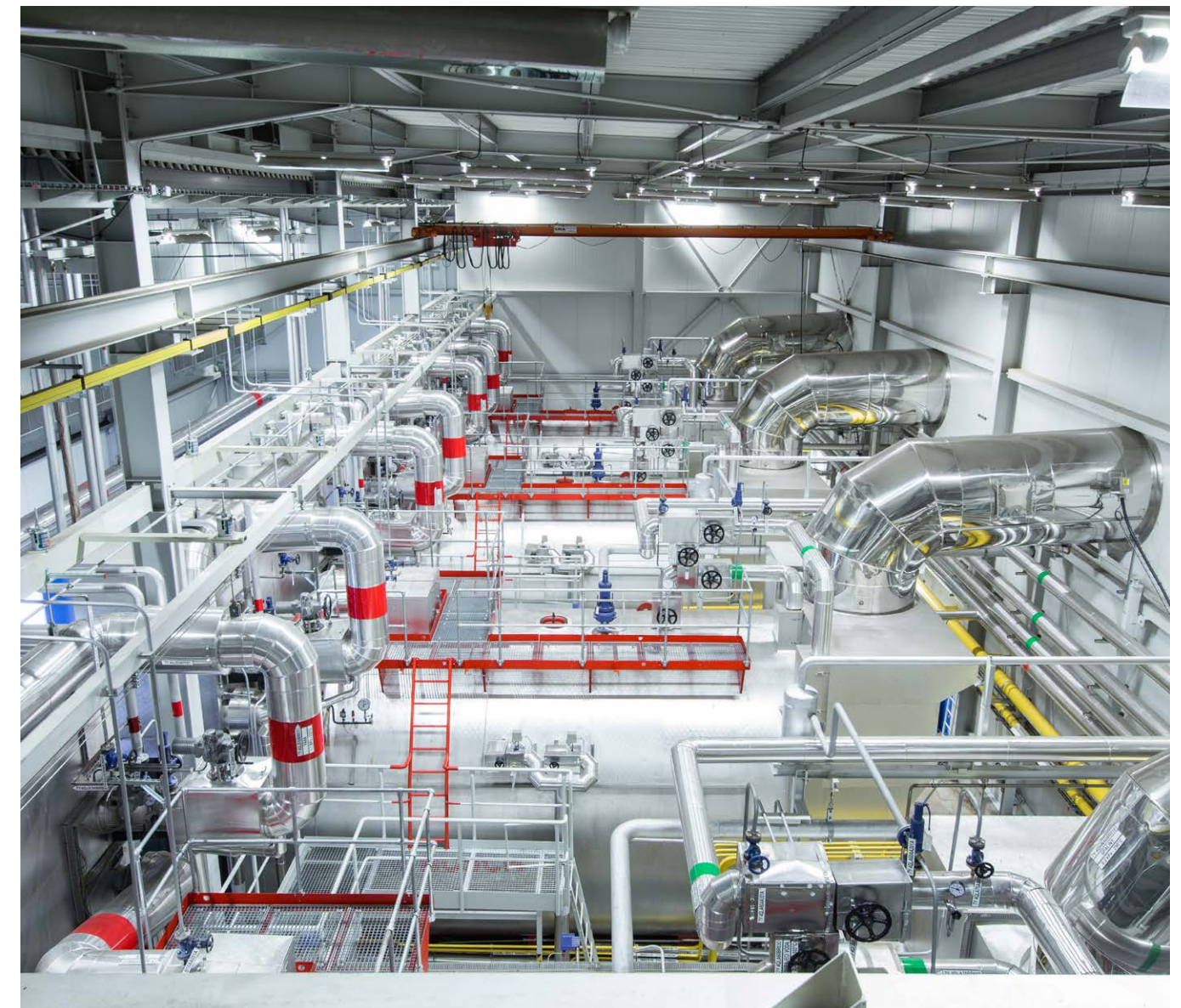
Čtyři parní kotle ZFR-X s provozní hmotností 145 tun každého z nich
