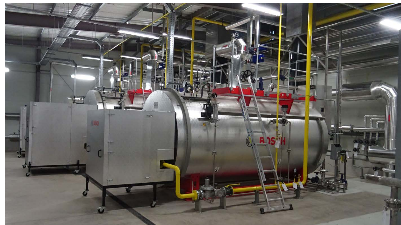
Systém kotlů v kotelně A2: 1 x parní kotel UL-S, 7 700 kg/h 2 x parní kotel UL-S, 4 600 kg/h
