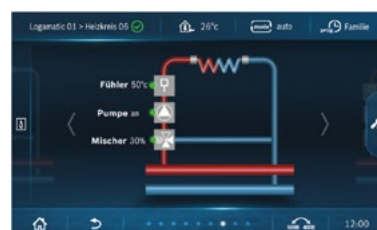
Monitoring / ruční ovládání topného okruhu
