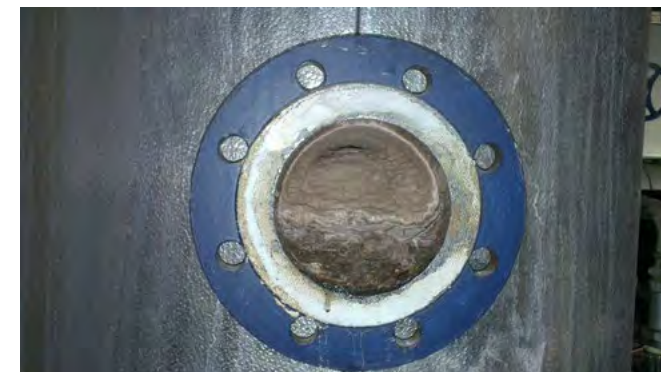
Obr. 32 Zdemontovaný přepad na modulu BEM; úplné zanesení BEM vápennými usazeninami
