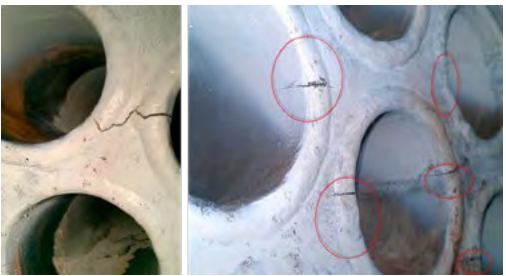
Obr. 24 Spalinová strana s trhlinami v trubkovnici obrátové komory
