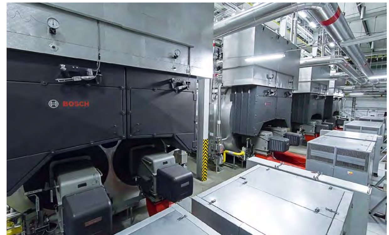
Obr. 73 Dvouplamencový kotel s namontovaným přehřívákem
