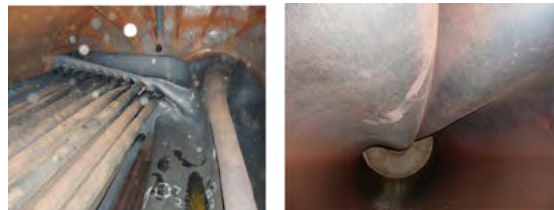
Obr. 33 Deformace z důvodu přehřátí díky nedostatku vody
