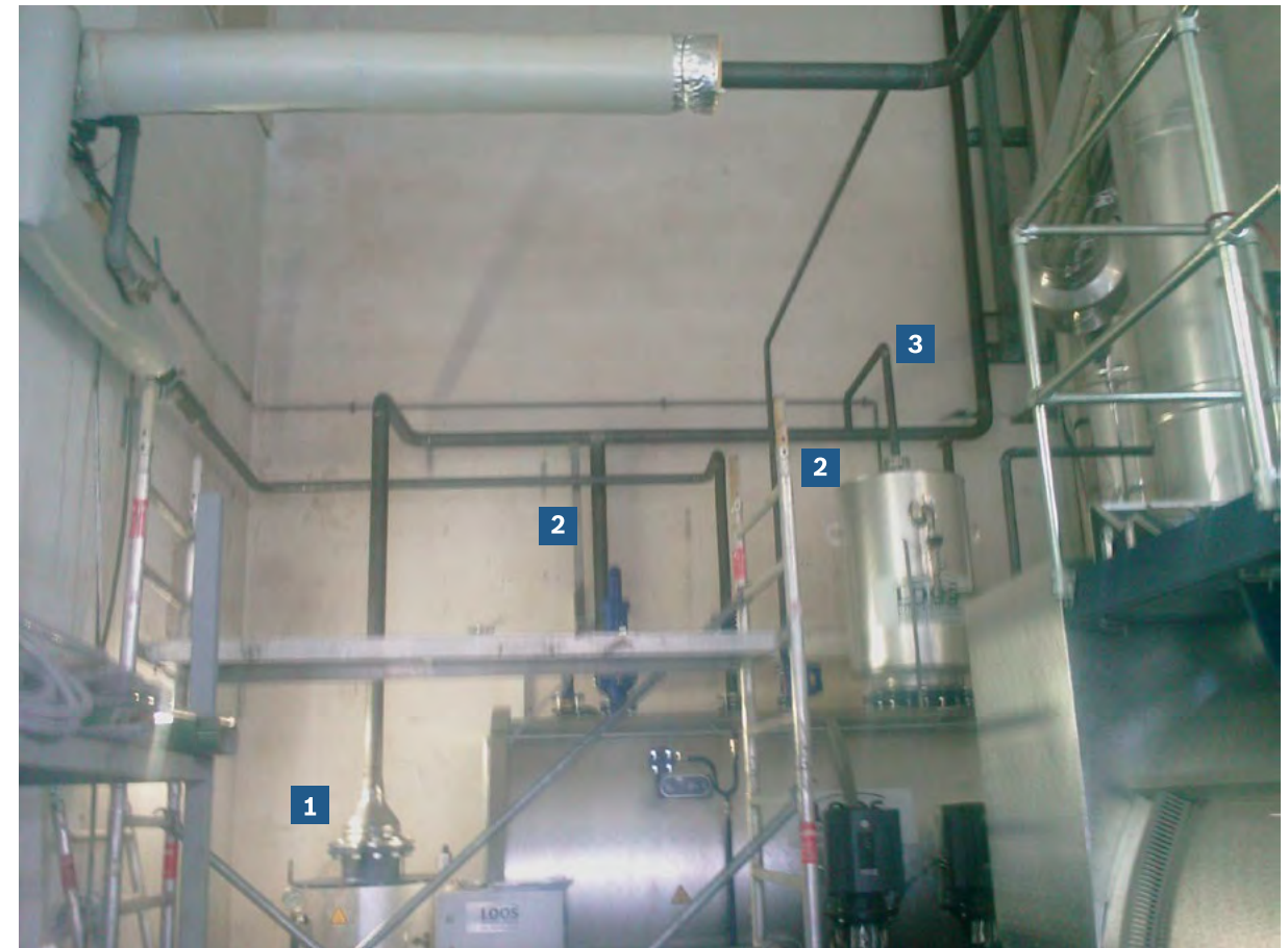
Obr. 18 Zúžení (1) potrubí expandované páry na odkalovací nádrži. Svedení (2) potrubí expandované páry od pojistného ventilu a potrubí brýdových par. Provedení potrubí brýdových par není v nerez(3).
