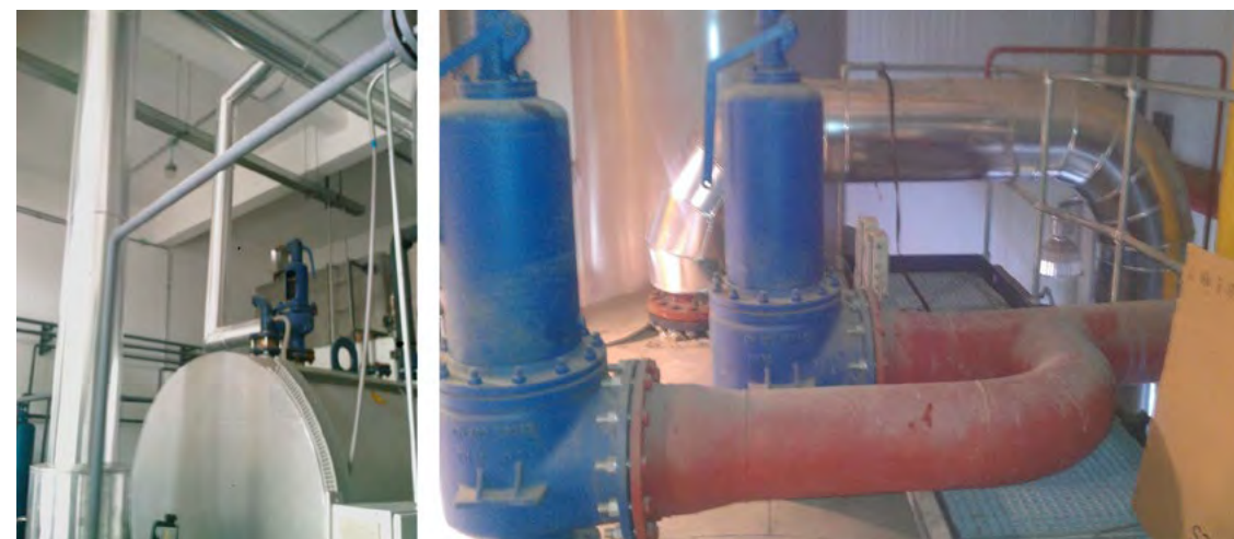
Obr. 16 Nepřipustné svedení potrubí bezpečnostního ventilu a potrubí expandované páry dohromady
