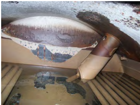
Obr. 23 Vápenaté usazeniny na straně vody na trubkovém poli a trubkovnici kotle
