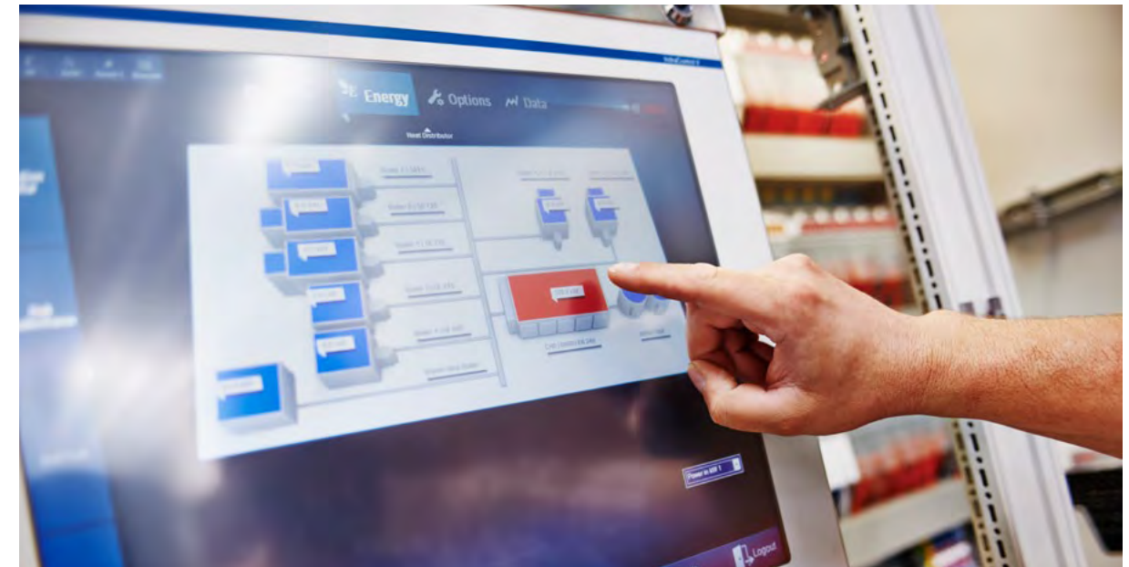
Obr. 226 Systém MEC k barevné a přehledné vizualizaci provozu a provozních stavů, teplot a zařízení
