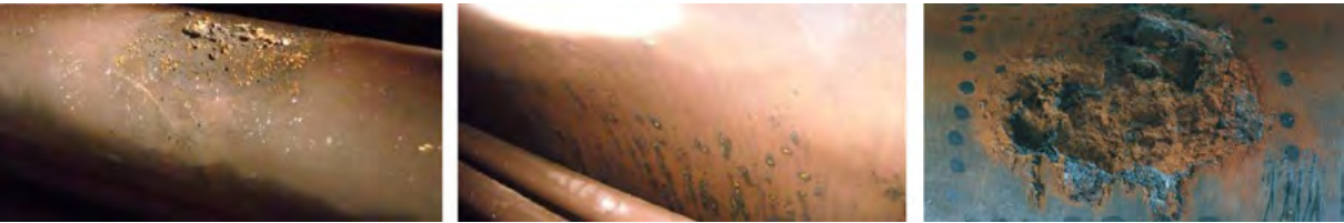
Obr. 95 Poškození korozí kyslíkem v kotli a na potrubích
