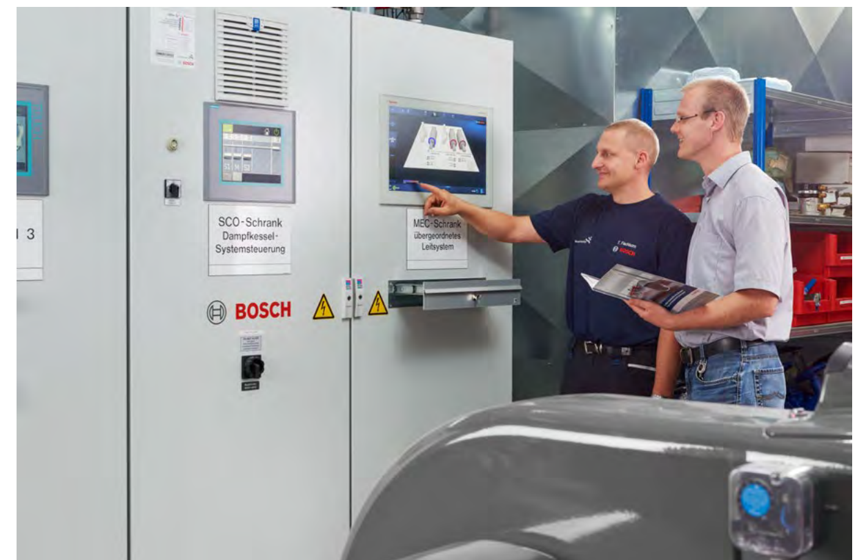
Obr. 117 Rozvaděče řídicího systému kotelny SCO a MEC System
