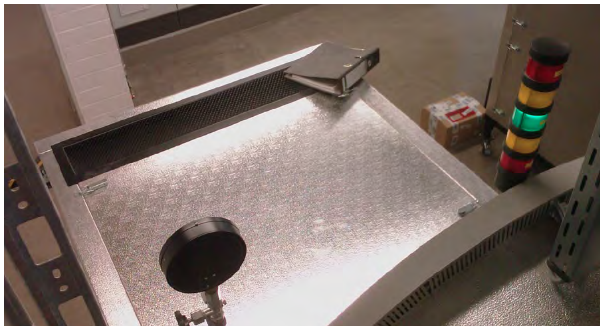
Obr. 30 Nebezpečí nedostatku vzduchu zablokováním otvorů přívodu vzduchu
